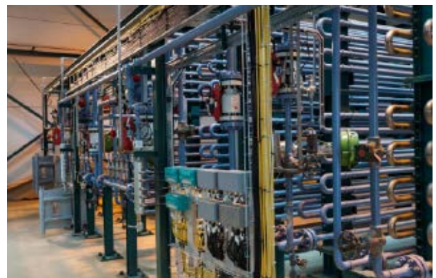
Figure 4. CO 2 Transport Experimental Facility at CIUDEN general view Figura 4. Vista general de la instalación experimental de transporte de CO 2 de CIUDEN
